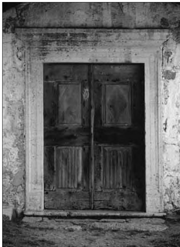
Sl. 6: Portal, ki sta ga sklesala brata Cerkvnik z Gradišča (foto: Branko Cerkvnik).
