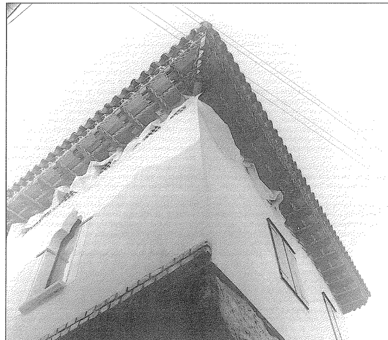
Koper, Obzidna ul. 9 - hiša Favento Guzzi, zunanjščina po končanih restavratorsko-konservatorskih delih. Po obnovi sedež koprskega oddelka MZVNKD Piran.
